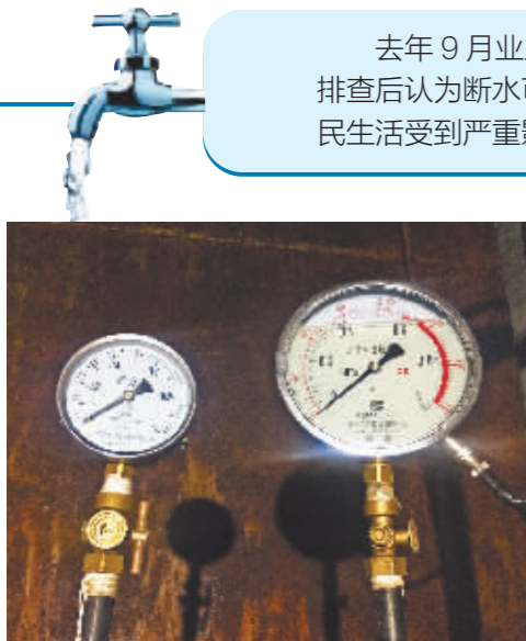
水箱外的压力表指向“0”,小区又停水了。
